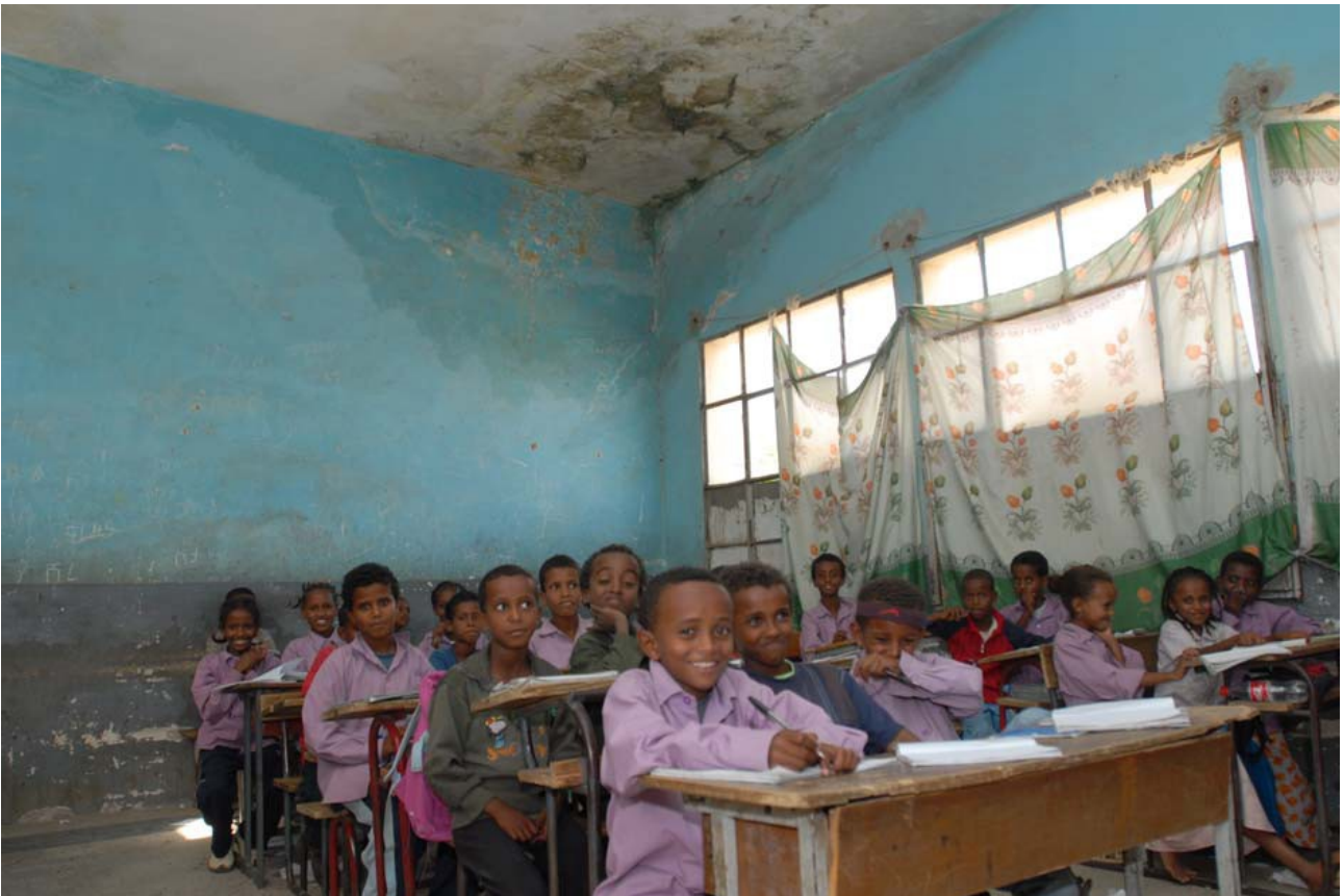
Die Selamschule heute: Schimmel an der Wand und eine einsturzgefährdete Decke.
