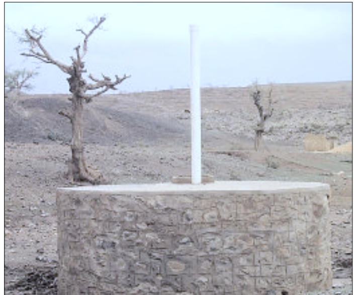
Die neuen Brunnen bleiben bis zum Anschluss an den Wasserhochbehälter versiegelt.
