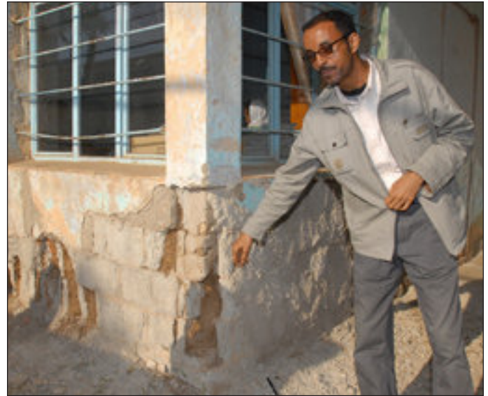
Tesfagiorgis zeigt uns die erheblichen Schäden am Bürotrakt.
