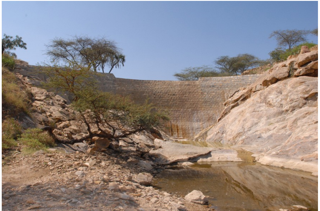
Damm Nr. 4: Dammkrone mit Überlauf, November 2007
